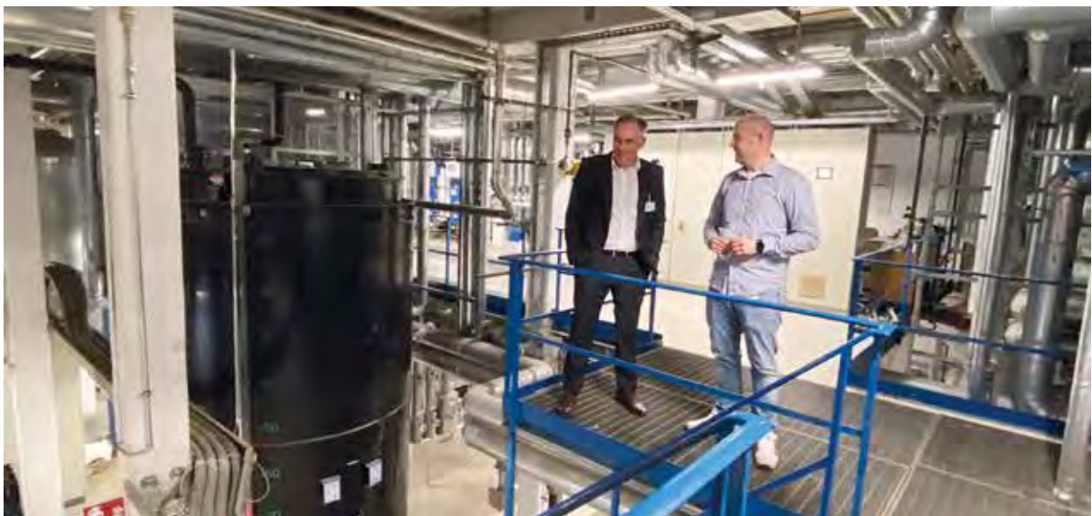
Bestandaufnahme in der Heizungszentrale
